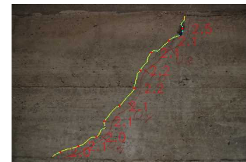
コンクリート橋の ひび割れの長さ・幅の検出
