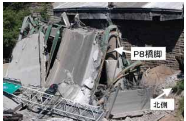
図-4 橋梁崩壊の順序 11)
